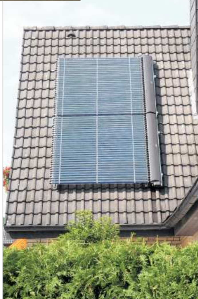
Hier hilft die Sonne bei der Brauchwassererwärmung.
